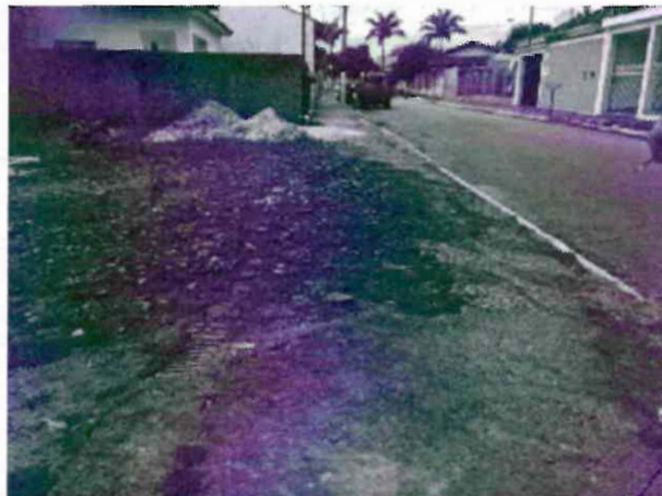
A1, Rua Capitão Maneco, trecho entre Rua da Saudade e Av. Prudente de Moraes, Lado Esquerdo, Passeio Esburacado, Piso irregular
