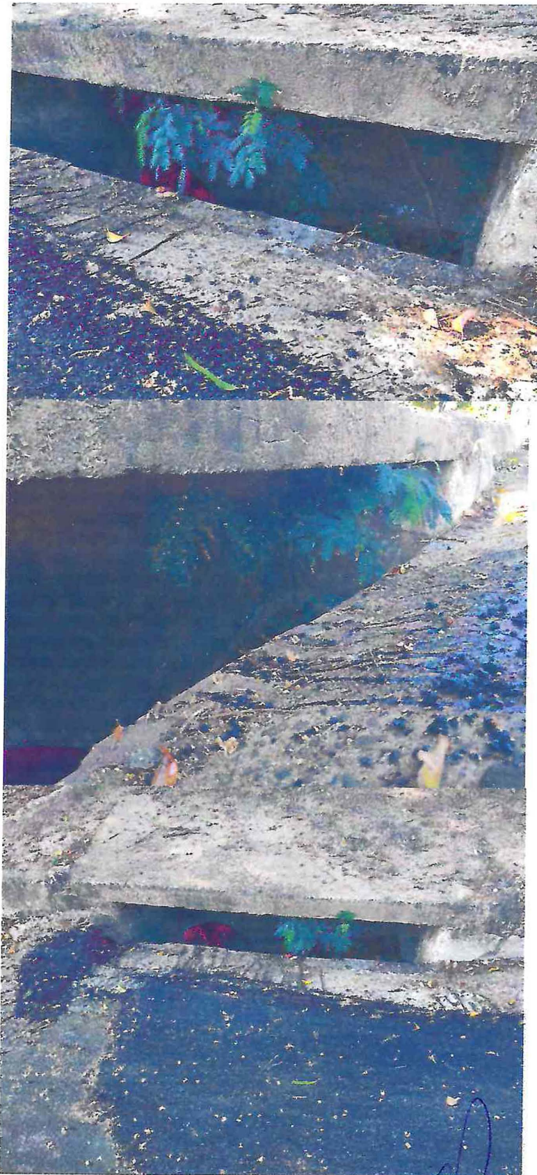
Ver César Ramos da Costa “Cesinha” - retirada de árvore de dentro de bueiro, localizado na Rua Semiramis Vieira de Moraes.
