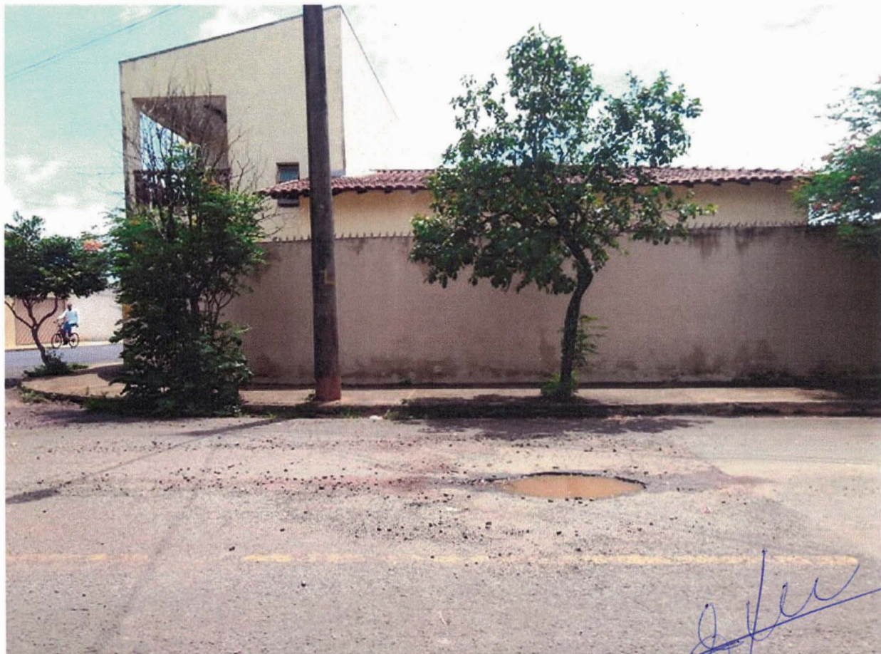
Ver Wallace – Rua Almiro Godinho ao lado do posto de saúde do Jardim Ferarezzi
