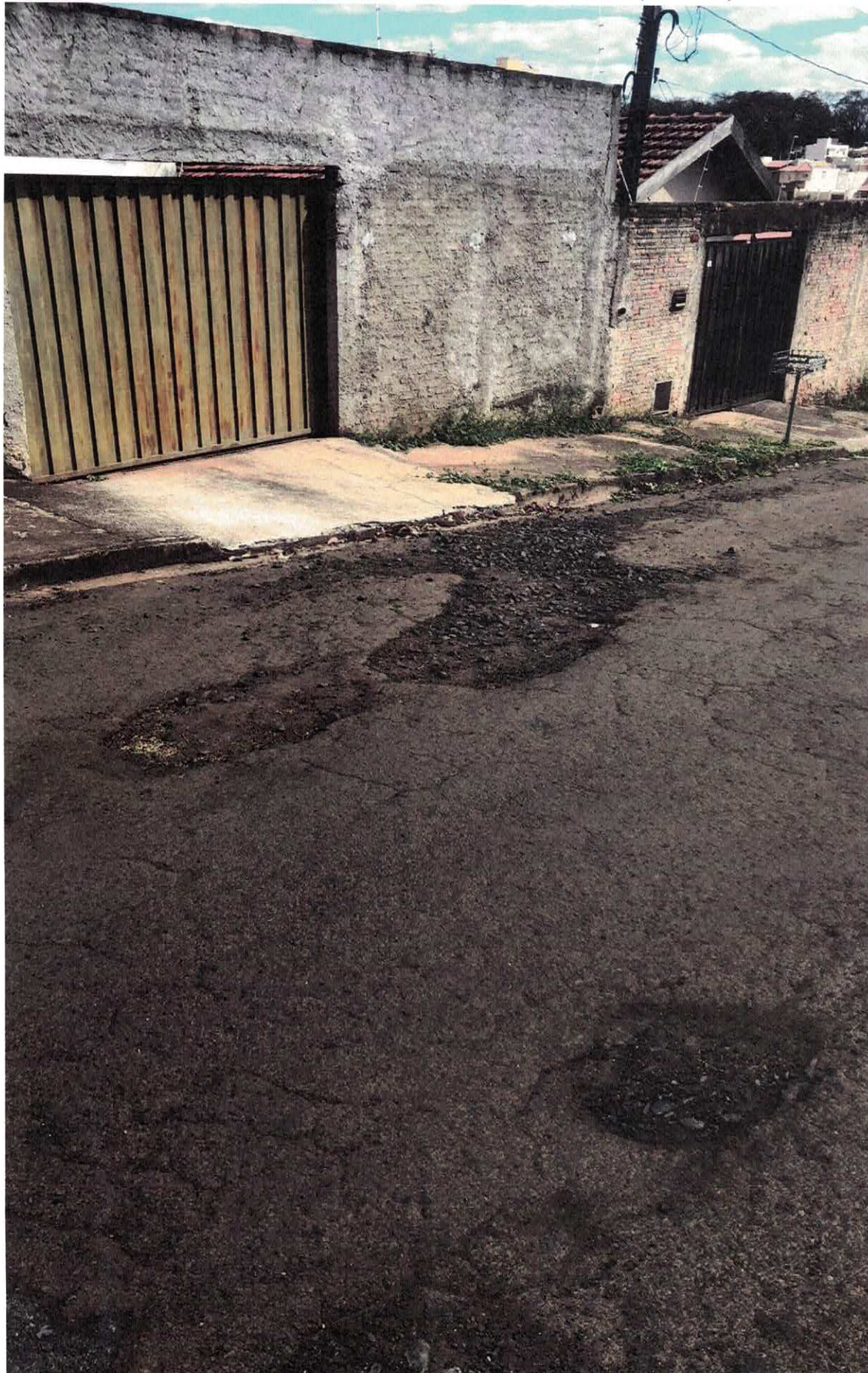
Ver Vitor Naressi Netto - tampar buraco na rua Dom Pedro II, nº 1798, no Centro.
