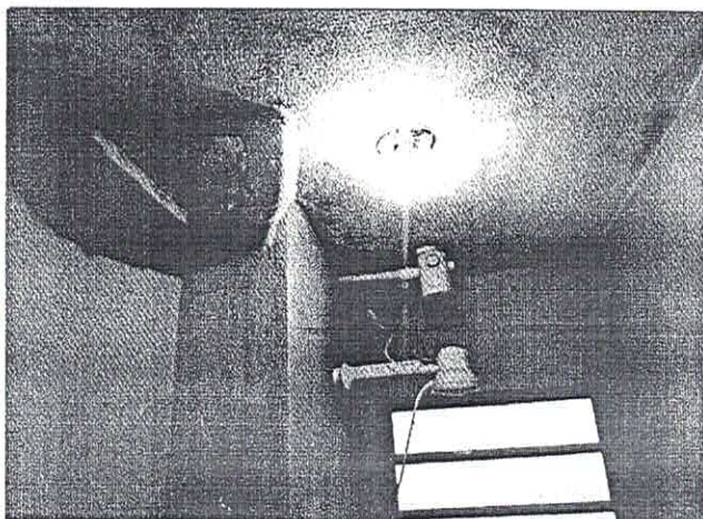
Vista da laje de teto do banheiro do apto 01B com infiltração
