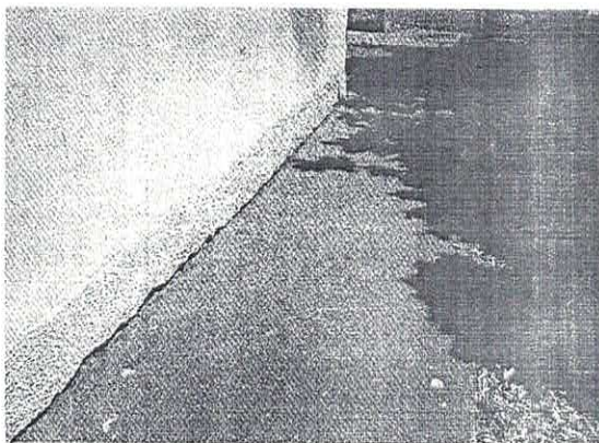
Trinca entre a calçada e o bloco G13A devido acomodação do solo
