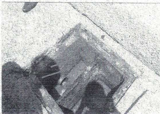
Caixa de inspeção de esgoto e gordura deteriorada do bloco G14
