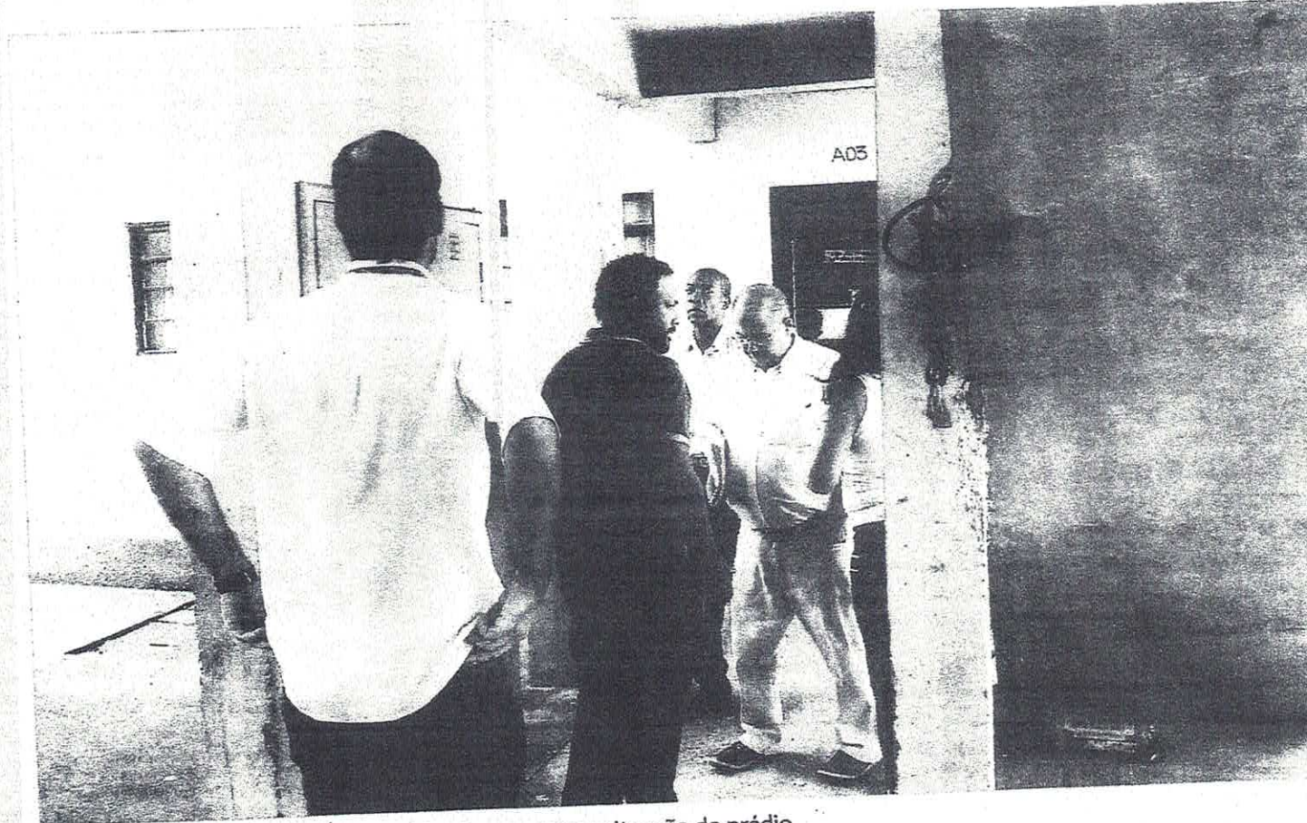
Engenheiros e Departamento de Habitação constataam situação do prédio
