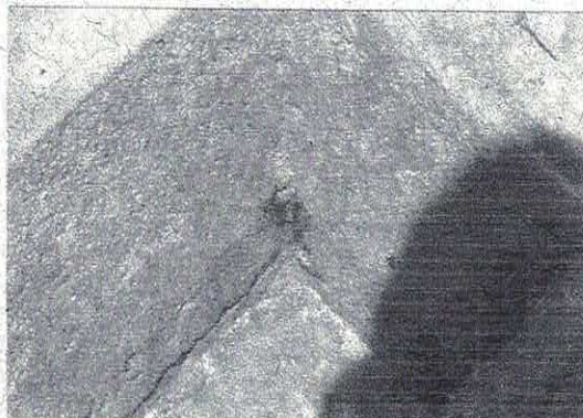
Detalhe da deterioração da parede da caixa do bloco G14
