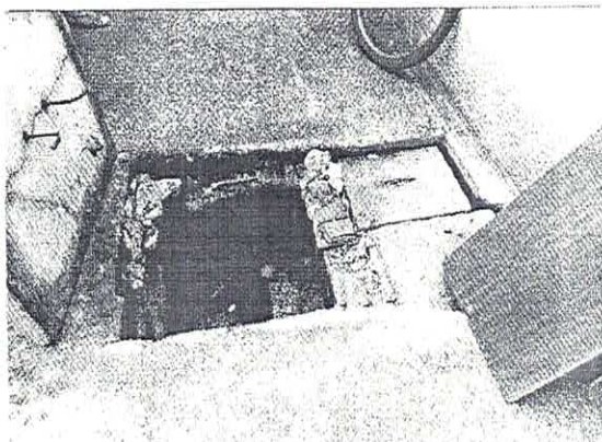
Caixa de inspeção de esgoto e gordura deteriorada do bloco G14
