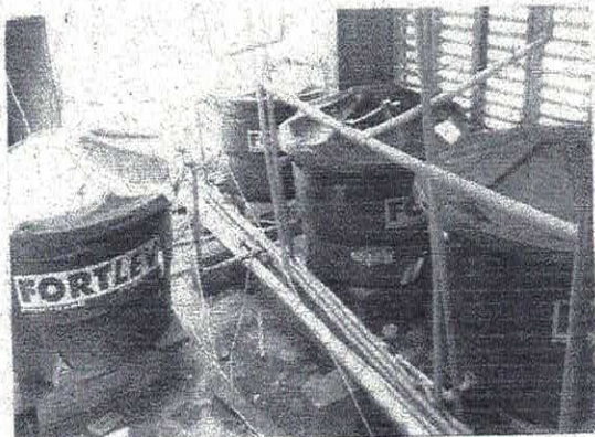
Reservatórios instalados na laje de cobertura da escada (barrilete) do bloco G14B
